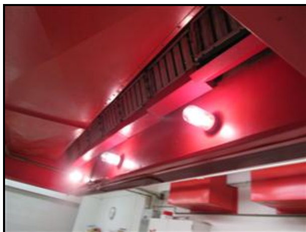
K. Picture 11 Exhaust Hood
